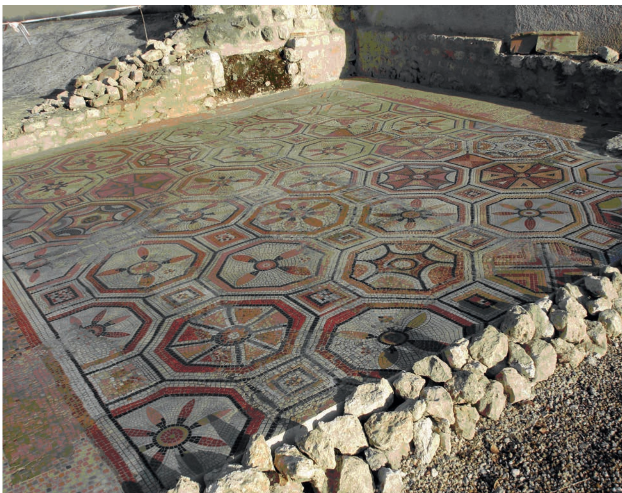
Figure 6. Mosaïque du vestibule soumise aux intempéries.
