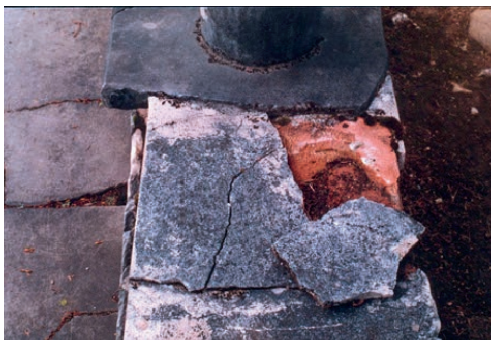
Figure 7. Villa de Montmaurin (France, Haute-Garonne) : éclatement de l'enrobage d'une galette de béton suite à l'action de l'humidité dans les thermes (R. Dupont).
