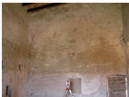
Fig. 108. Fotografia on s'observa l'arrencament de la volta superior de la torre, la qual cedí a l'ensorrar-se la façana meridional de l'edifici.
