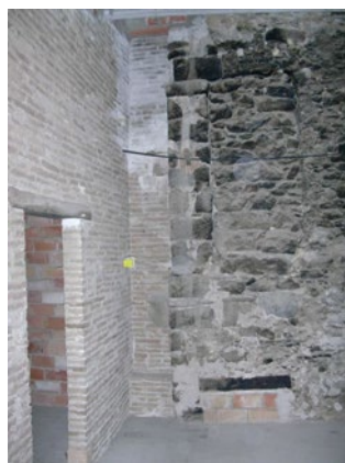
Fig. 96. Pilar cantoner de l'antic badiu. Avui es conserva integrat en un mur.
