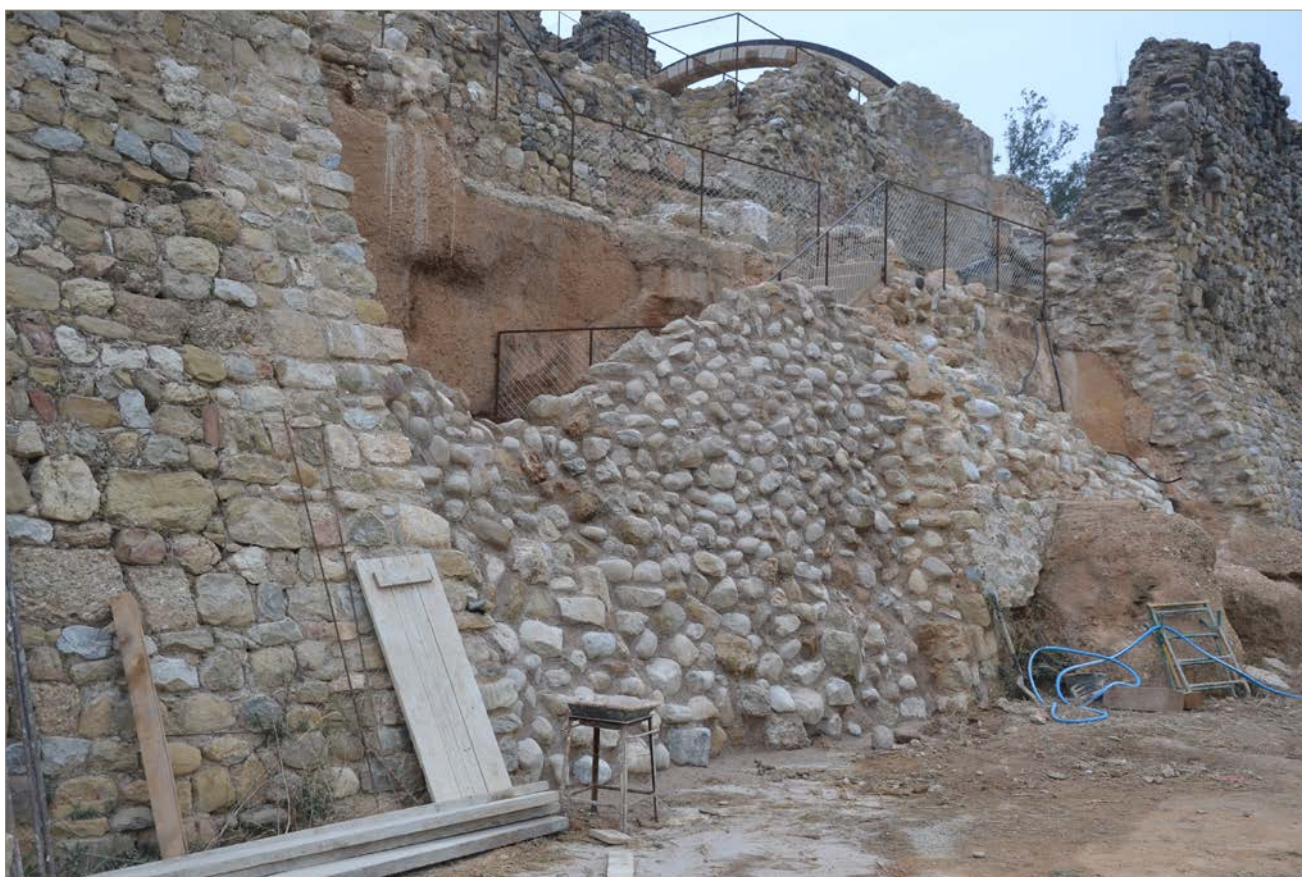
Figura 2. Vista exterior de la muralla sud del castell després de la seva recuperació.
