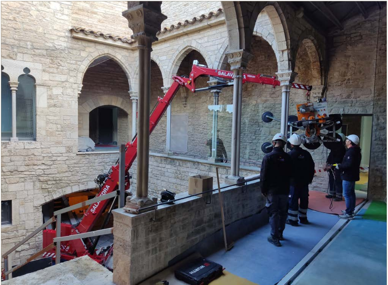
Figura 1. Collocació dels vidres a la galeria del pati de la Pia Almoïna, durant les obres a l'edifici històric.
