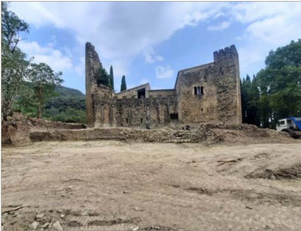
Figura 2. Vista del costat sud del Castell de Falgons un cop finalitzats els treballs.
